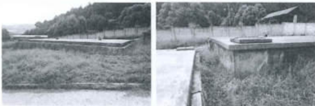
Fuente: RIC, Alta Verapaz, 2020. Tanque de distribución de agua entubada a la aldea Tampó
