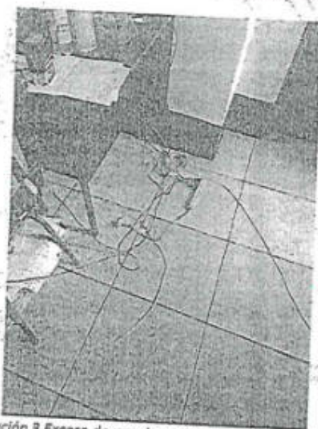
Ilustración 3 Exceso de uso de regletas en distintas oficinas
