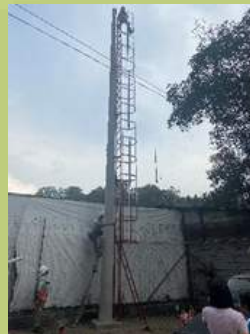
Estructura de concreto (poste) para colocar la antena de la RAC A
