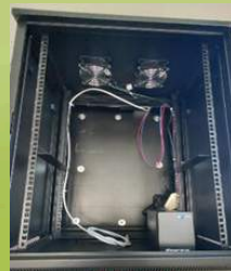
Estructura metálica (caja) para ubicar equipo de la RAC A
