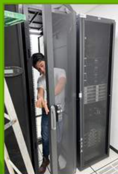
Adquisición de Gabinetes (rack) de piso para el Centro de Datos
